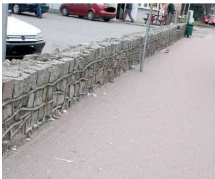
Tak wyglądało przed remontem...
